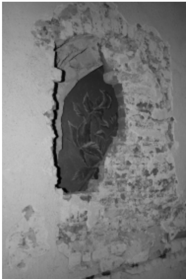
Tijdens de verbouwing is een ingemetselde nis weer te voorschijn gekomen, deze wordt in ere hersteld.
